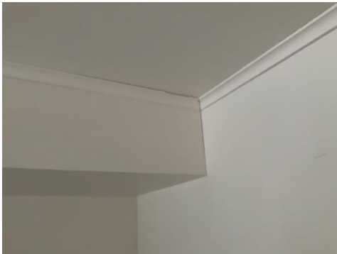
Sprekker i hjørner.
