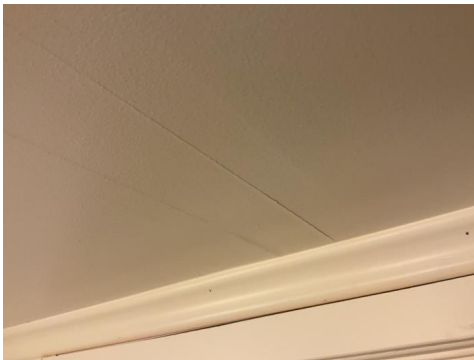
Sprekk i plateskjøt i himling.
