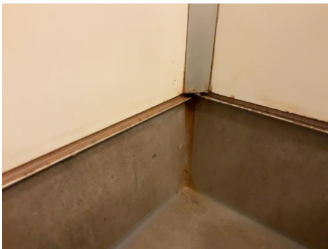
Antydning til vannskade i nedre kant av veggplate i dusjsone.
