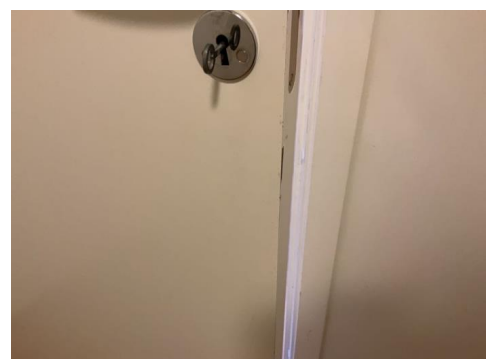
Slitasje på innvendig dør.
