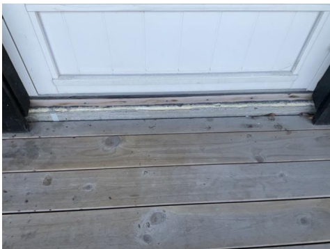
Manglende underbeslag på ytterdør.
