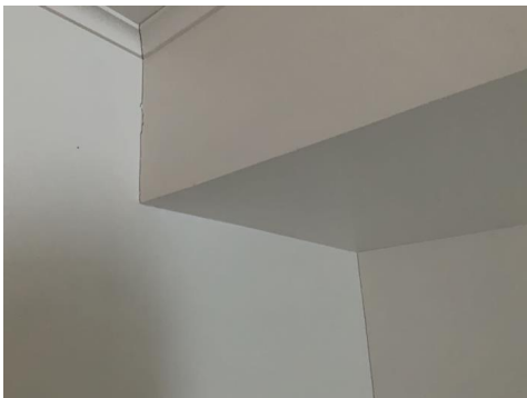
Oppsprekk i hjørner.
