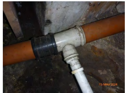
Avløpsrør i krypkjeller.
