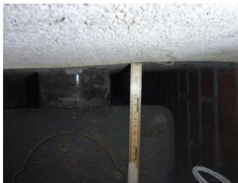
Viser avstand < 10 cm fra pipe til ovn.
