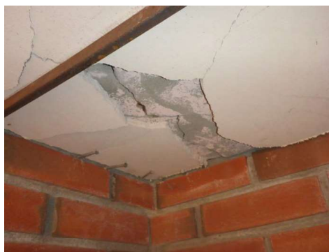
Viser skade underside av peis.
