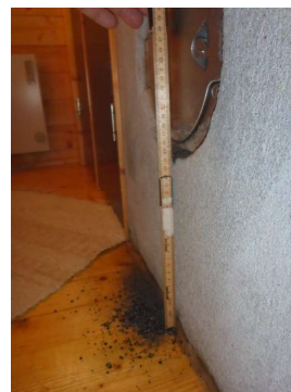
Viser avstand < 30 cm fra sotluke til brennbart gulv.
