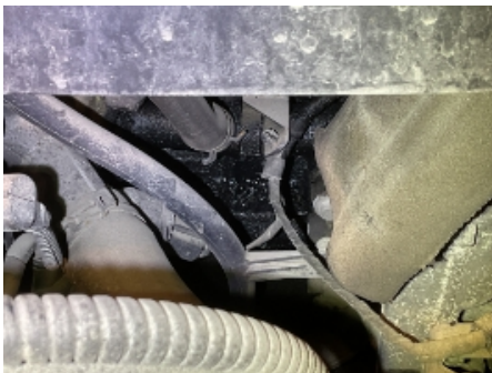
19. Utvendig tilstand motor
