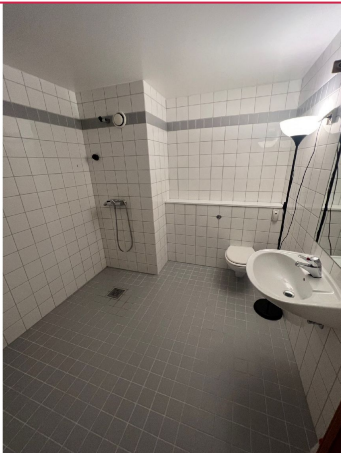
Romslig bad. Det skal settes opp dusjvegg ved dusjen. Lampen på badet er kun satt der for å lyse opp
