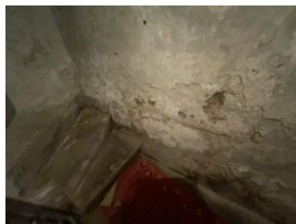
Eldre betong kan ha redusert kvalitet Kondens innvendig kan oppstå ved manglende utvendig isolering av grunnmur. Løs puss.
