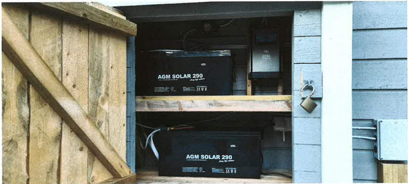
Batteripakke 2*290 AH, 60A lader og hovedstrømsbryter 12V
