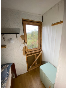
Veggplate, foringer og listverk mangler. Soverom mot vest.
