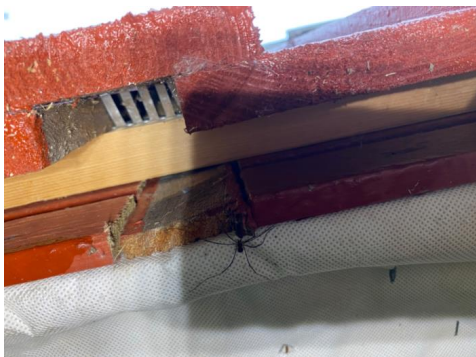
Musebånd bak nyere kledning.
