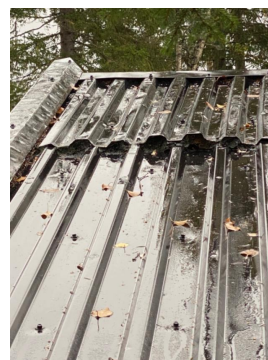
Ikke fagmessig tetting av skjøtt på takplater.
