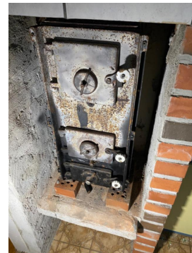
Ildfast plate på gulv under vedovn på kjøkken mangler. Hovedregelen er at ildfast plate skal dekke 30 cm foran ovnsdøren, men det er viktig å følge bruks- og monteringsanvisningen til peisovnen.
