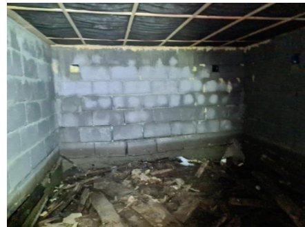
Påvist mye fukt i krypekjeller.
