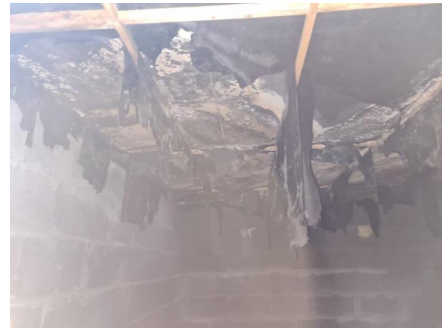
Papplaget henger fra stubbgulv under trebjelkelaget i deler av krypekjeller.
