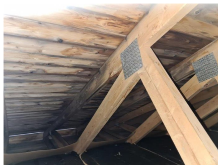
Bilde tatt på kaldloft. Fukt- og tildels noe råteskadet taktro nedenfor pipe.
