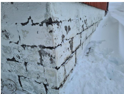
Riss og sprekkdannelser i grunnmur på hjørne (sørvest) av boligen.
