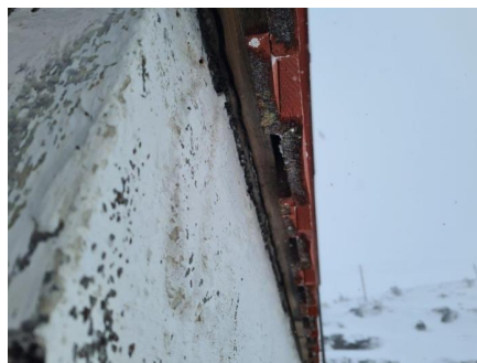
Luftet tømmermannspanel. Endeved er ikke mettet med beis/maling.
