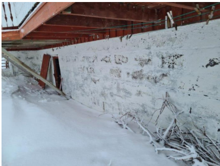
Grunnmur av lettklinkerblokker. Ukjent utførelse av dreneringen.
