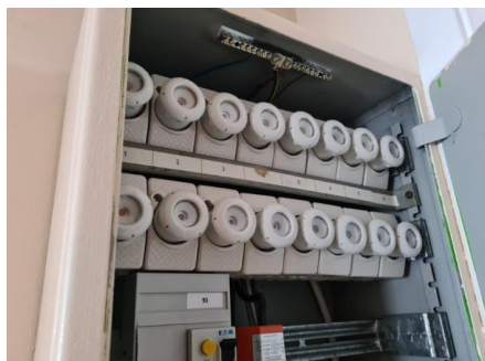
Sikringskap med skrusikringer.
