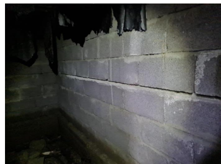
Horisontale riss/sprekkdannelser i grunnmur (mur mot øst - mot tilfylt side).
