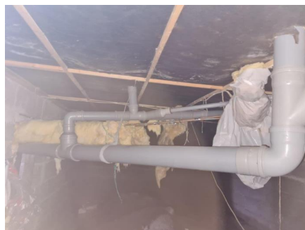
Avløpsrør i kjøkkenbenk.
