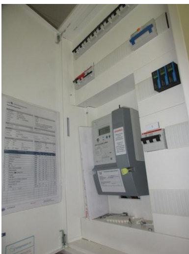
El-anl med automatsikringer og kursoversikt
