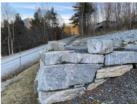
Støttemur uten rekkverk
