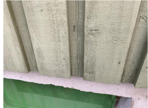
Malingslitt og noe småsprukken trekledning
