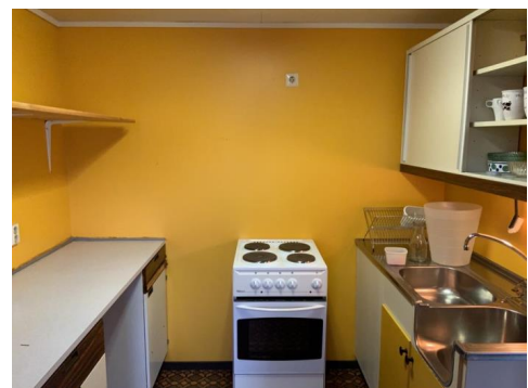
Komfyrplassering uten mekanisk avtrekk
