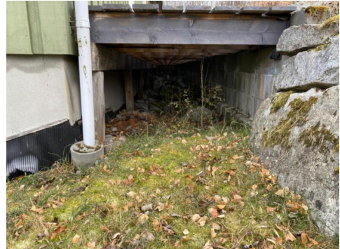
Terrengfall mot bygning
