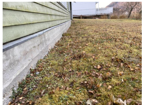
Terrengfall mot bygning
