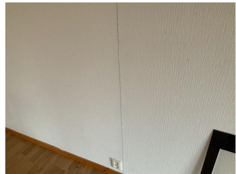
Riss i platekledd vegg
