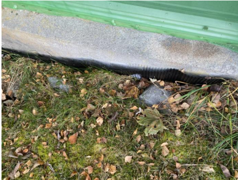
Manglende avslutningslist på drensplater
