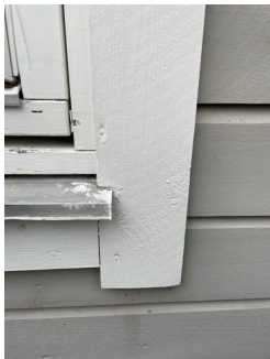
Omremming av vindu ligger tett på vannbrettbeslag.
