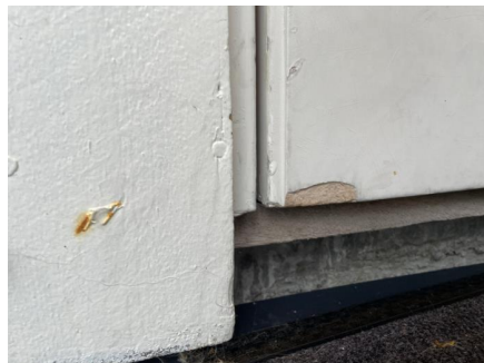
Sårskade på nedre kant av dørblad for ytterdør
