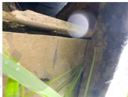
Lufting av kledningen er ikke iht. dagens anbefalte løsning, men heller ikke dårligere enn normal løsning ved husets byggeår.
