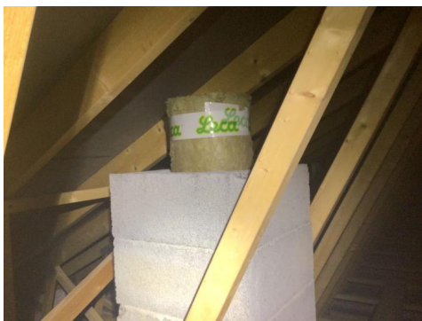
Pipe avsluttet på kaldtloft.
