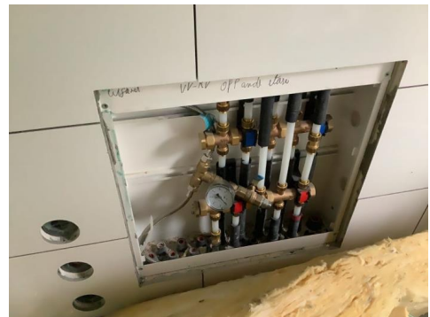
Stoppekran plassert på teknisk rom.
