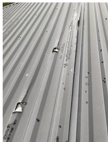
Yttertak - [Skader, yttertaktekking]
