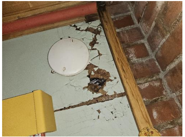
Overflater vegger - [Fuktmerker/råteskade, vegg]
