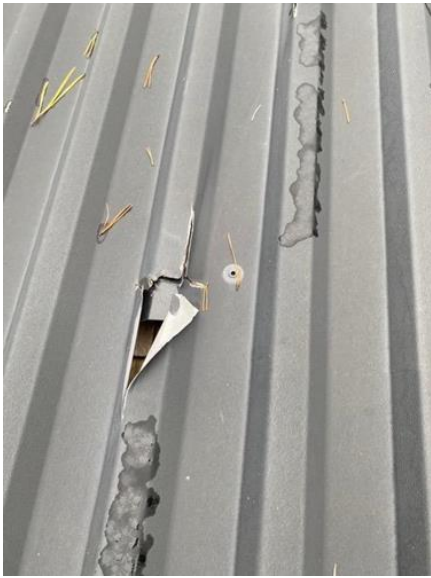
Yttertak - [Skader, yttertaktekking]
