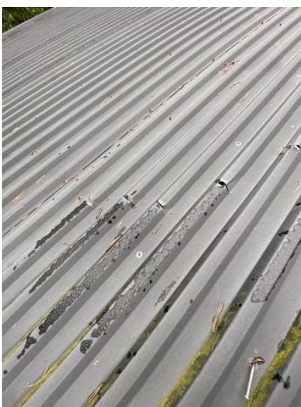
Yttertak - [Skader, yttertaktekking]
