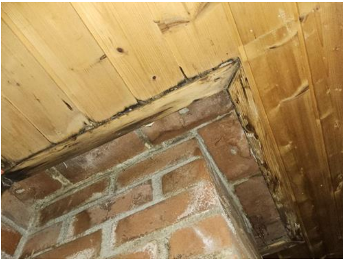
Overflater himling - [Fuktmerker/råteskade, himling]
