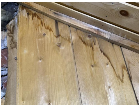
Fuktmerker fra område ved pipe
