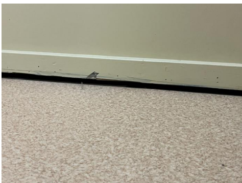
Sprekk mellom gulv og gulvlist.
