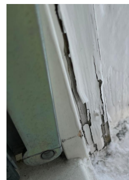
Værslitt omramming og avflasket maling.
