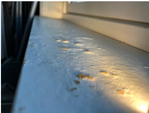
Svelling i vinduskarm på bad i 1. etasje.
