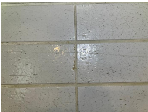
Sprekker i flisfuger i våtsone
