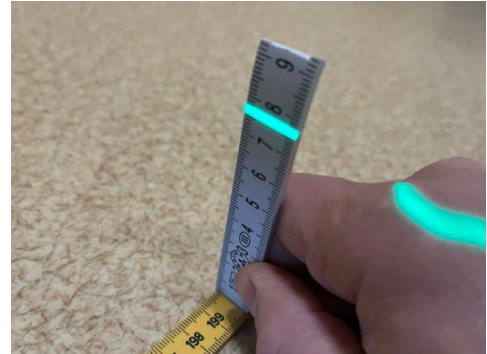
Målt høydeavvik i gangen på loftet.
