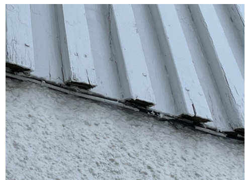
Trekledning med oppsprekninger i nedre kant.
