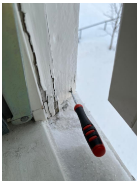
Råteskade og malingsavflassing rundt vindu.
