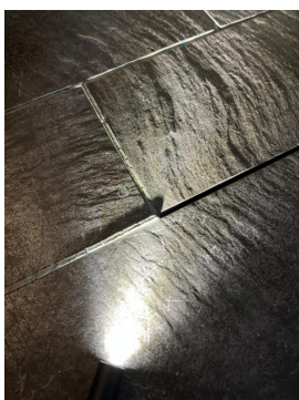
Helt løse fuger i flisgulv i 1. etasje.
