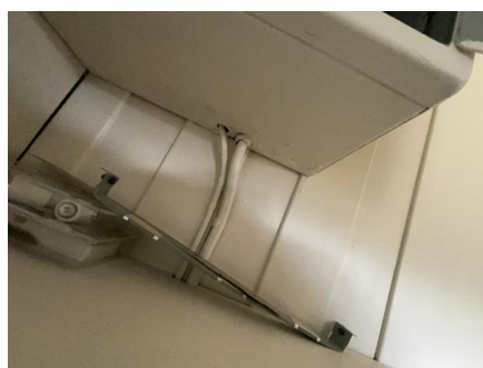
Mangler tetting av hull på sikringsskap.
