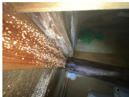
Kondens på etasjeskiller
