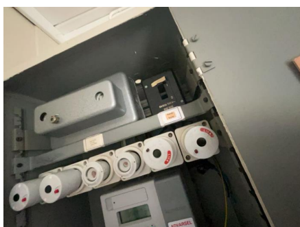
Sikringsskap plassert på soverom.
