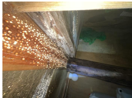
Kondens på etasjeskiller
