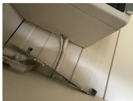
Mangler tetting av hull på sikringsskap.
