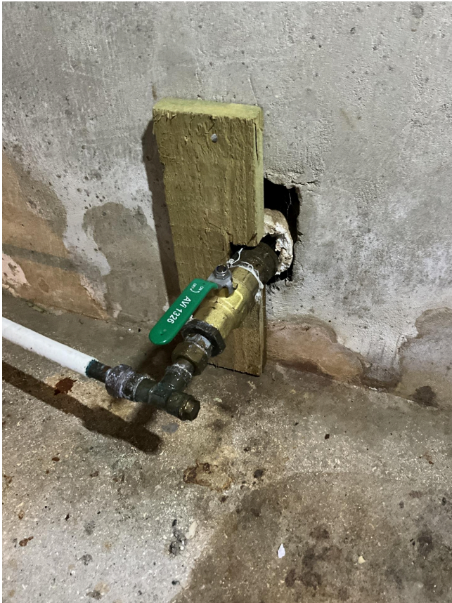
Hovedstoppekran med plassering i kjeller.
