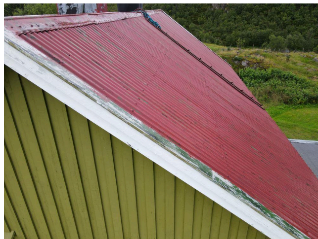
Vannbordene har behov for utskifting.
