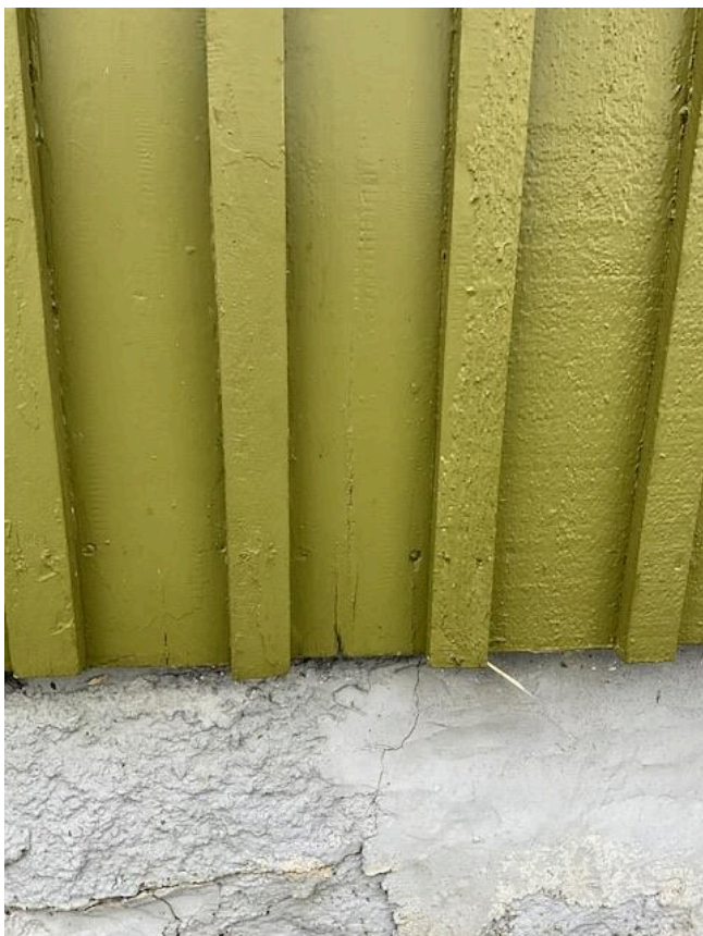
Noe tørkesprekker på endene av kledningsbord.
