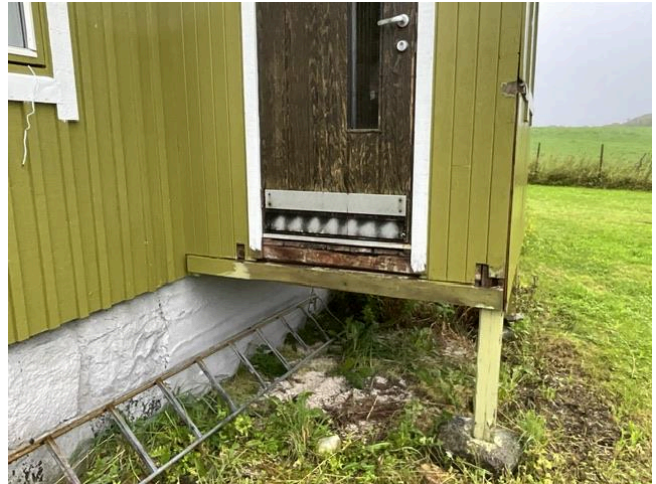
Trapper til tilbygget mangler
