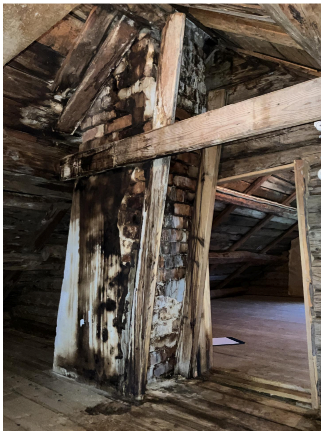
Murte pipe på kaldloft. Det er preget av tidligere lekkasje rundt pipe. Det ble målt etter fuktighet på befaringsdagen uten at det var for økte fuktverdier ut over det normale. Og det regner hele dagen på befaringsdagen.
