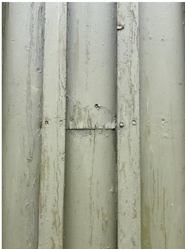
Noe slitt i overflaten.
