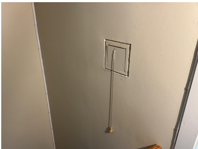
Ventiler i veggen.
