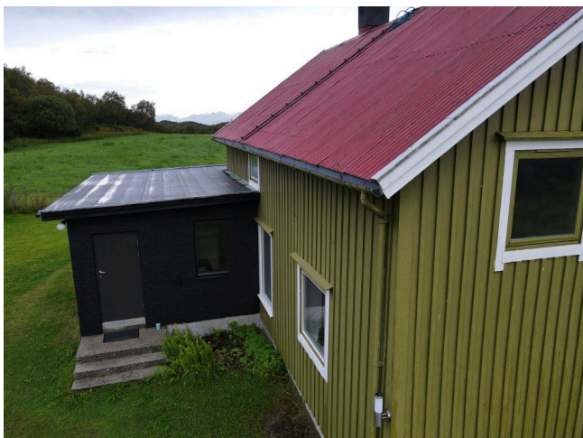
Takrenner og nedløp i plast av ukjent alder.
