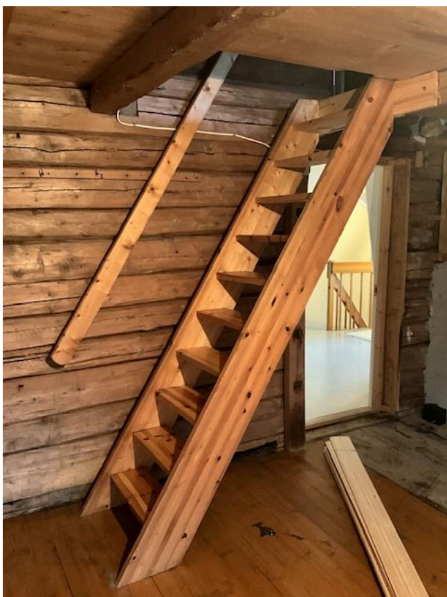
Trapper fra andre etasje til loft. Trappen mangler gelender på høyre side.
