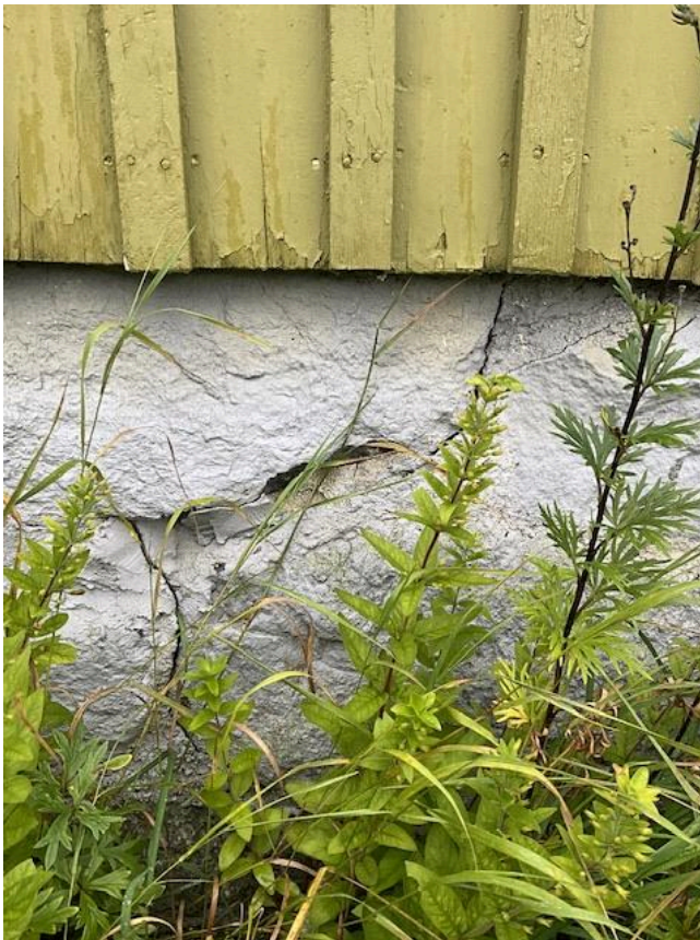
Sprekk i muren.
