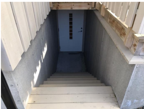
Mangler håndløper, fare for fall.
