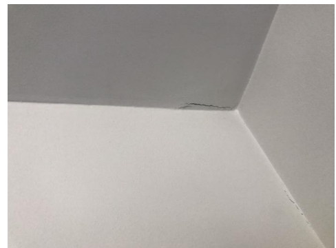
Synlig sprekke i stue
