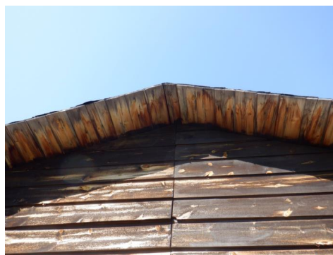
Ingen lufting i takkonstruksjonen.
