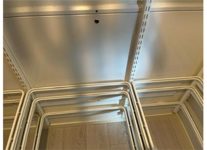
Fördelarskåp till golvvärmen gick inte öppna pga monterade hyllor. Vattenlarm kan med fördel monteras vid skvallerrör för att kunna upptäcka eventuella läckage.
