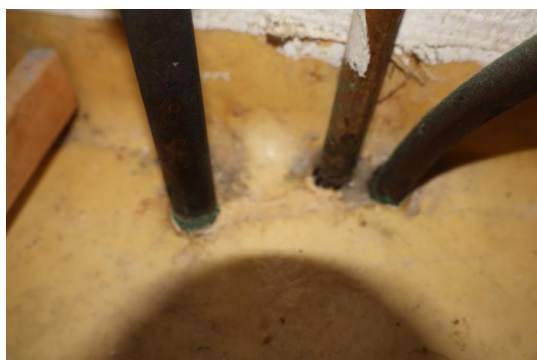
Utett rundt rør som kommer opp igjennom gulvbelegget.
