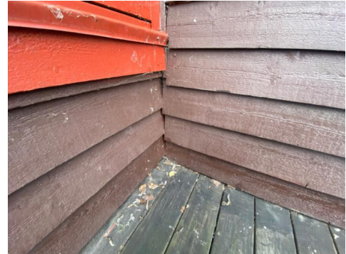
Bilde viser kledning som ikke er ihht. bransjestandard.
