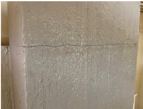
Bilde av sprekk i pipe.
