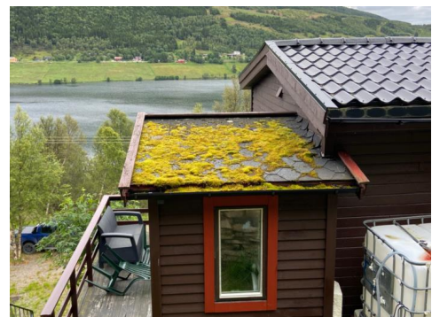
Bilde av takrenne og beslag ved vaskerom.
