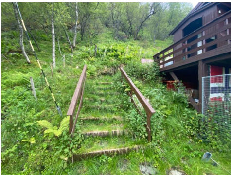
Trapp i terreng. Trapper går delvis fra vei og opp til hovedinngang.
