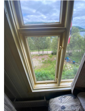
Vindu i stue. Vindu er fuget mot karm, og kan ikke åpnes.
