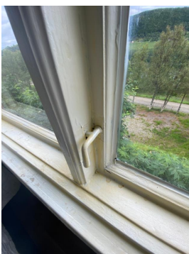
Bilde av vindu i stue med flekkende maling og sprukket treverk.
