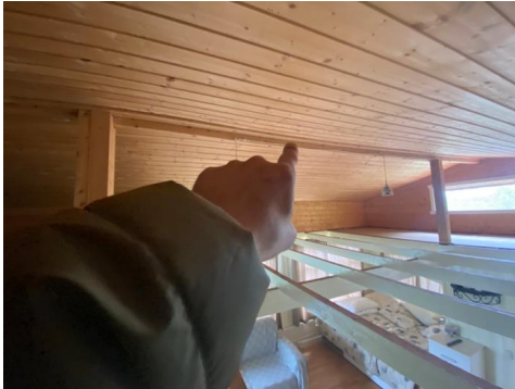
Bilde av innvendig mønedrager med nedbøy.
