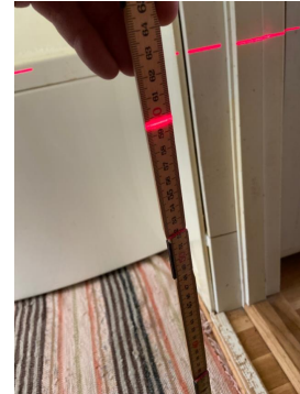
Bilde viser målt høydeforskjell på toalettrom.
