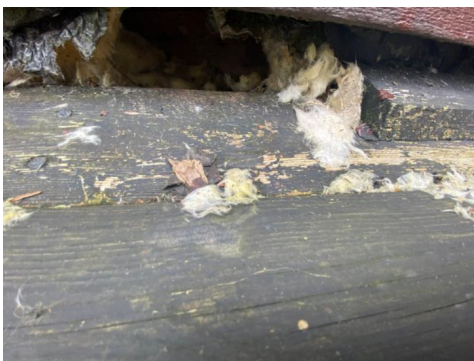
Bilde viser hull i konstruksjon etter skadedyr.
