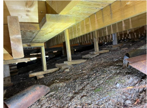
Enkel og ufagmessig fundamentering
