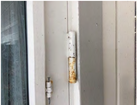
Eksempel på rustskadet beslag/hengsel
