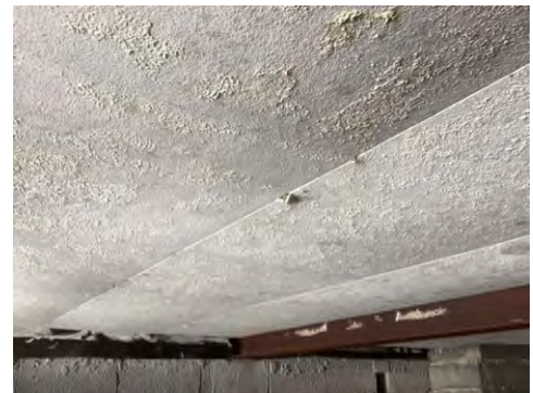
Eksempel på skadet himlingsplater
