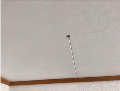
Eksempel på skadet himling
