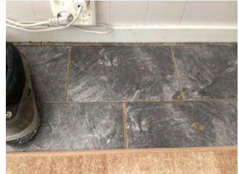
Eksempel på mangler ved laminatgulv
