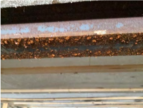
Rustskadet stålbjelke i bjelkelag
