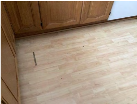
Skadet gulv på kjøkken
