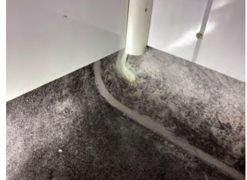
Eksempel på ikke fagmessig utførelse av hjørner.
