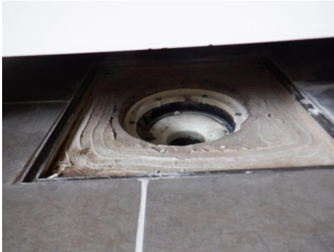
Sluk under dusjkabinett
