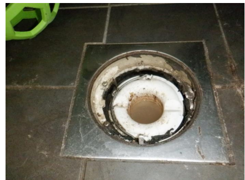
Sluk under innredning
