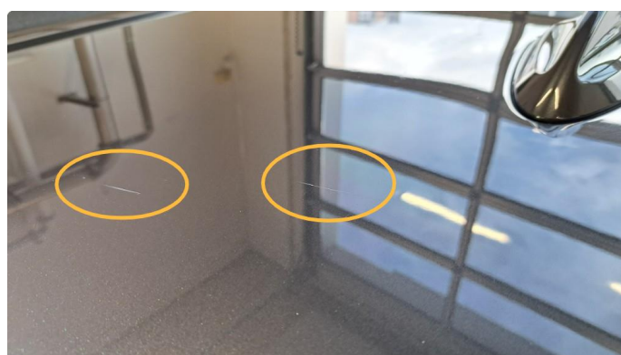
1.15 Steinsprut. og noen riper.
