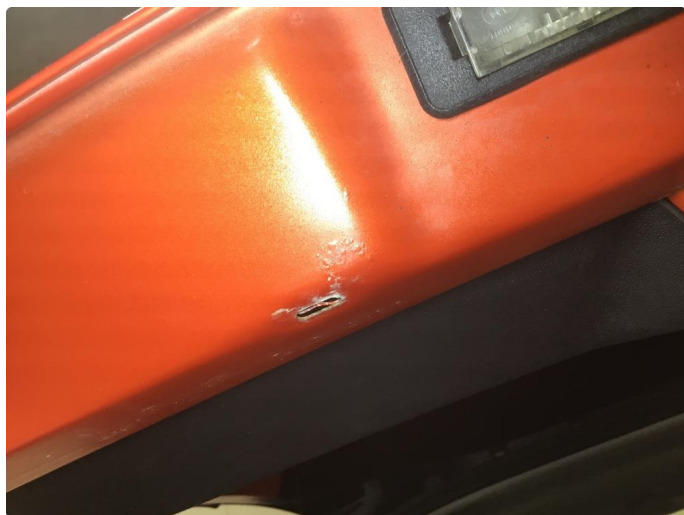
1.9 Bakluke - rustblærer innvendig
