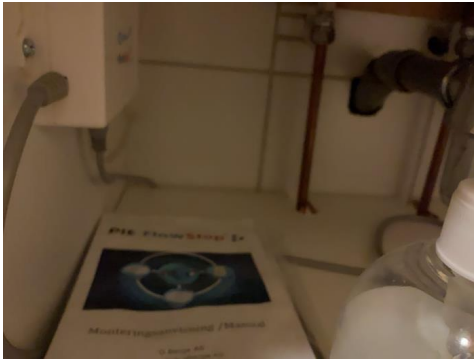
Manglende tetting rundt rør inne i servantskap.
