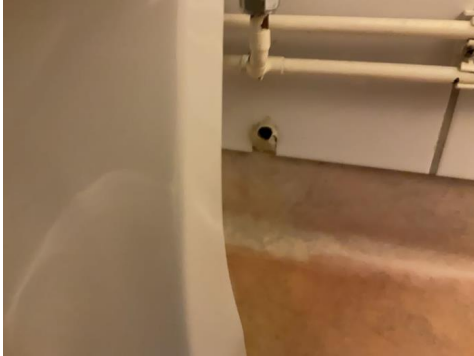
Manglende tetting rundt rør i vegg ved wc.
