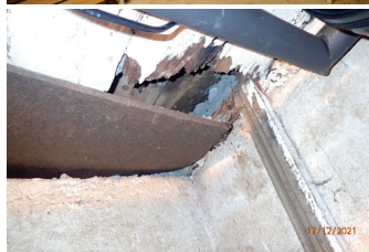
Råteskader i etasjeskille mot yttervegg (opplyses å være av eldre dato, ikke endret seg siden utbygging i 1970).
