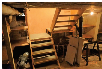
Trapp ned til kjeller uten rekkverk og fri høyde i trapperom er lavt (under 2,00 m).
