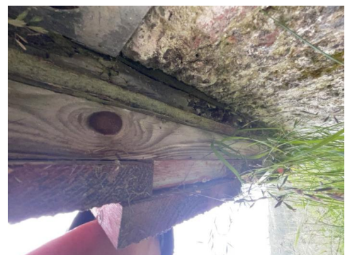
Mangler lufting bak kledningen
