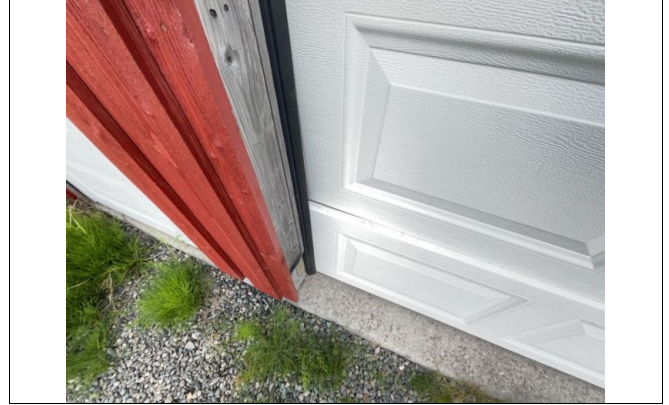
Forskjøvet portblad pga manglende hengsel
