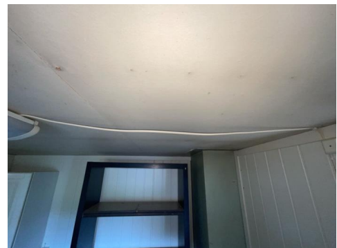
Løs ledning i taket
