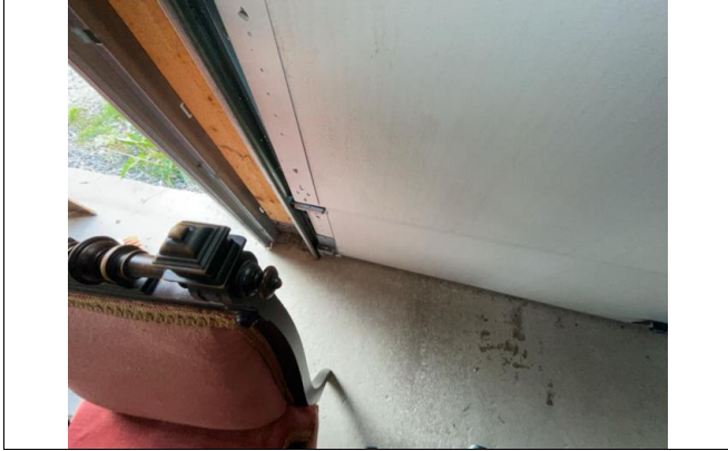
Manglende hengsle på garasjeport
