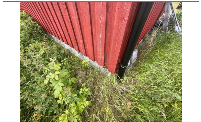
Slitte utvendige overflater på garasje
