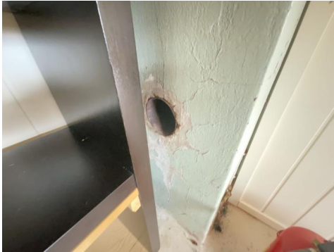
Røykinntak som ikke er tett
