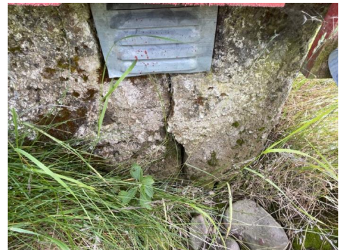
Sprekk/setningskade i grunnmur
