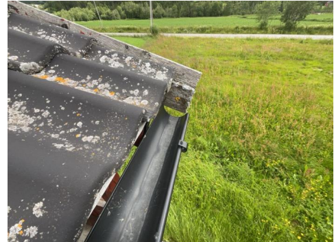
Takrenne mangler endelokk og nedløp
