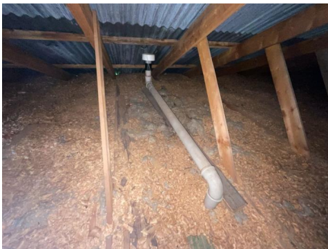
Lufting av kloakk
