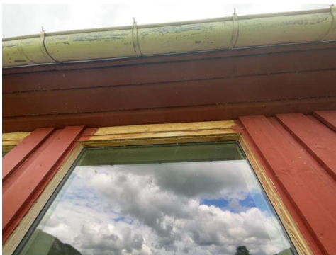
Mangler utvendig kledning over vindu.
