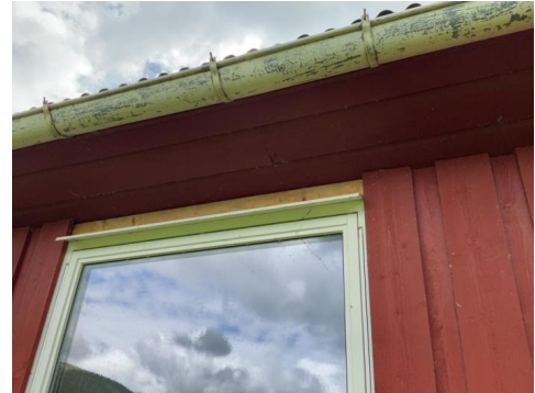
Mangler utvendig kledning over vindu
