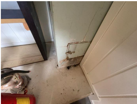
Sotluken ligger helt inntil brennbart materiale
