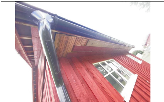
Manglende gesimskledning på garasje
