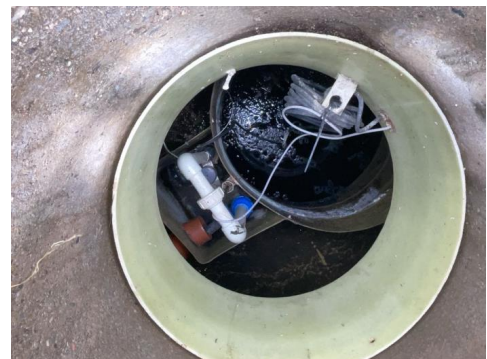
Septiktank med pumpe
