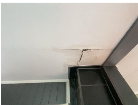
Skader i himling etter taklekkasje
