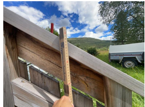
For lavt rekkverk på trappen
