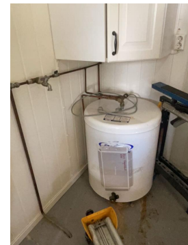
Bereder plassert på arbeidsrom
