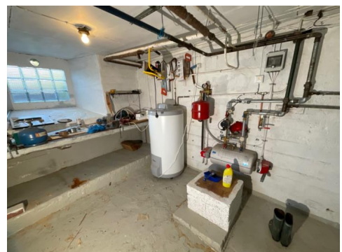
Høyax el.kassett og vannbåren sentralvarme til radiatorer.
