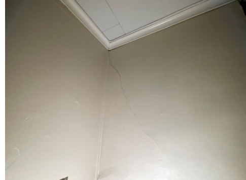
Sprekk i overflate
