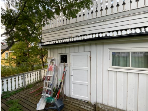
Skjevhet i takkonstruksjon
