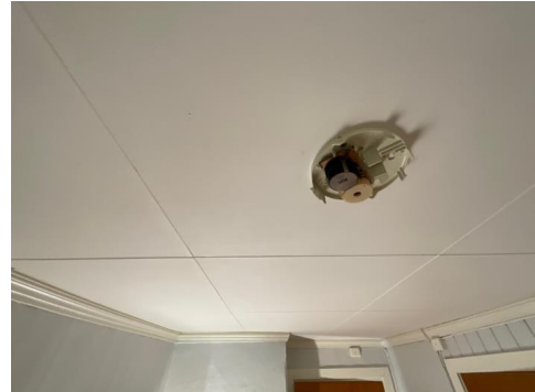
Røykvarsler v/ 2.etasje
