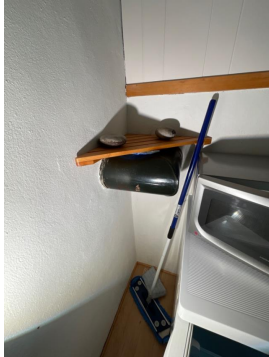
Treplate/hylle ved pipe- rør v/ kjøkken 2.etasje.
