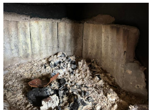
Skadet ildfast stein inne i ovn.
