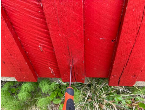
Eksempel på råteskade.
