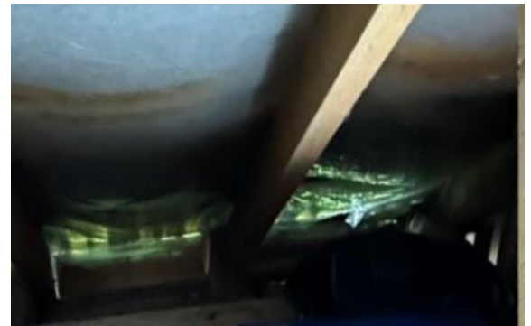
Skade på undertaket.
