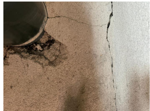
Riss ved røykrør og sprekke i overgang mellom pipe og brannmur.
