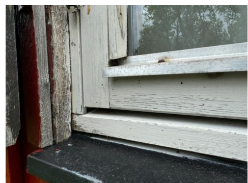
Værslitt, Beslag mangler oppbrett og treverk går helt ned til beslag.
