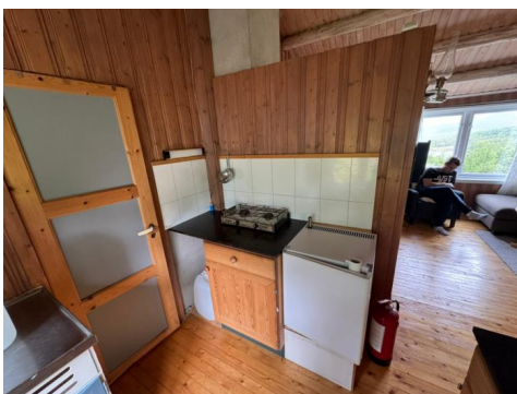
Fuktmerker under kjøleskap.
