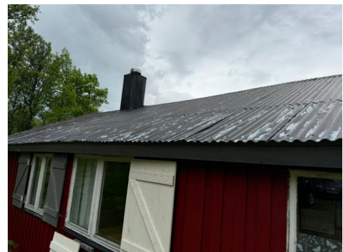
Manglende takrenne, nedløp og takstige.
