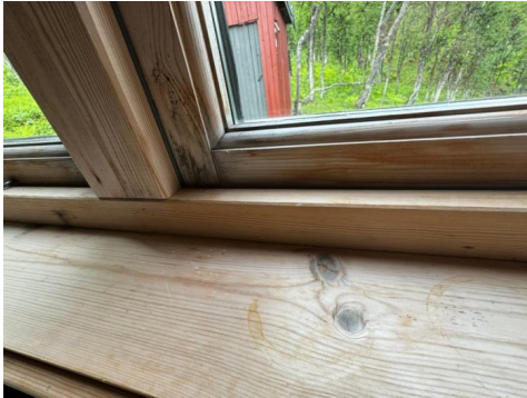
Symptomer etter innvendig kondensering.
