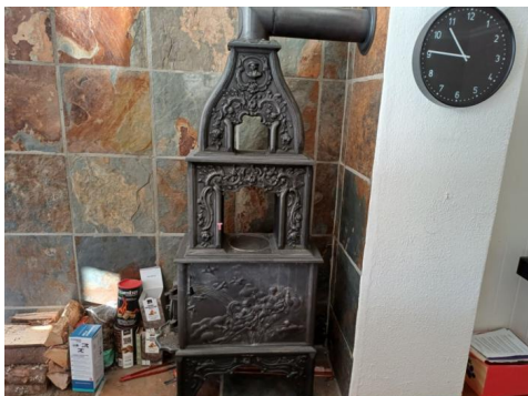
Vedovn i 1. etasje.
