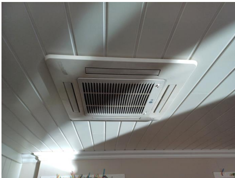
Varmepumpe i stue.
