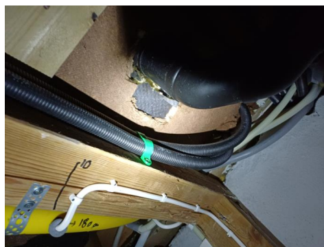
Utett rørgjennomgang, er opplyst tettet i ettertid.
