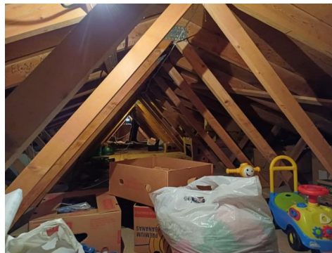
Noe dårlig lufting ved raft.
