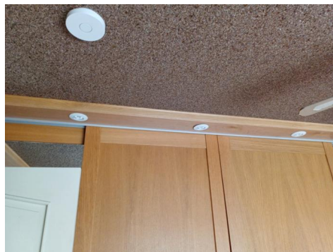
Røykvarsler i 1. etasje.
