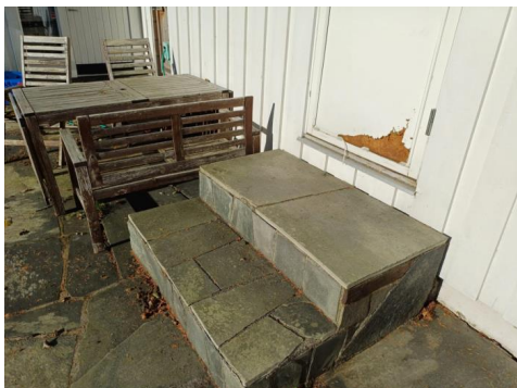
Balkongdør med skade på nedre del.
