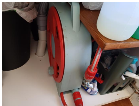
Husbrannslange i kjøkken 1. etasje.
