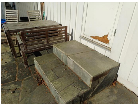
Balkongdør med skade på nedre del.
