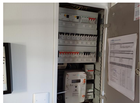
El-skap i 1. etasje.
