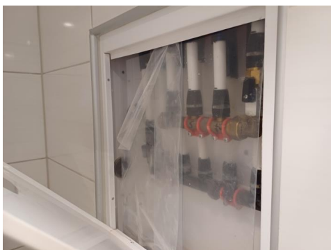
Fordelerskap for vann i hybel.
