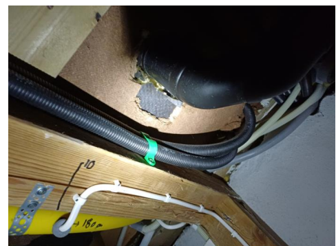
Utett rørgjennomgang, er opplyst tettet i ettertid.
