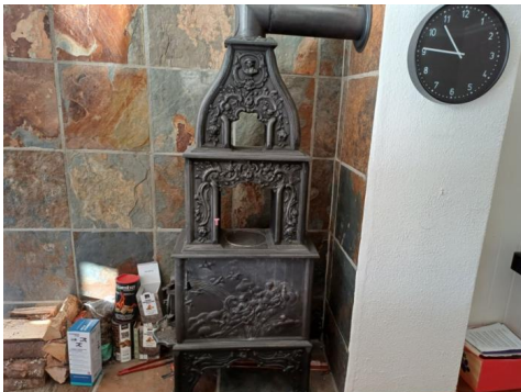
Vedovn i 1. etasje.
