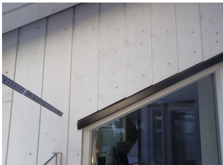
Manglende fuktsikring ved beslag.
