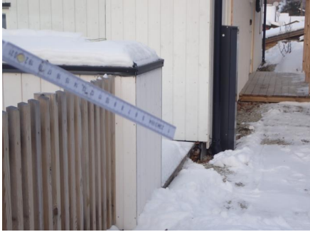
Manglende finish på grunnmursplast.
