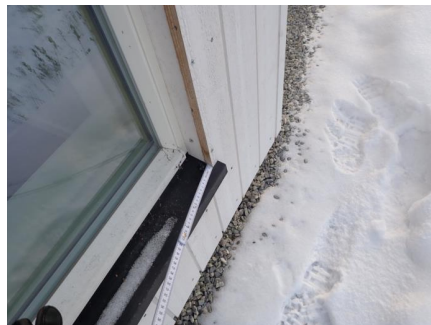
Manglende lufting på listverk/panel.
