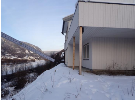
Usikret terreng nedside bolig.
