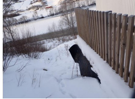
Manglende finish på grunnmursplast.
