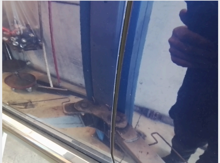
2.5 Små lakkskader på dørkanter alle dører
