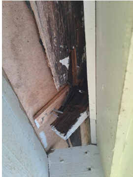
Råteskade i sperr og undertak tilbygg
