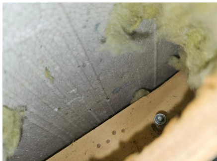
Det er ikke påvist misfarging eller andre symptomer inne i veggen.
