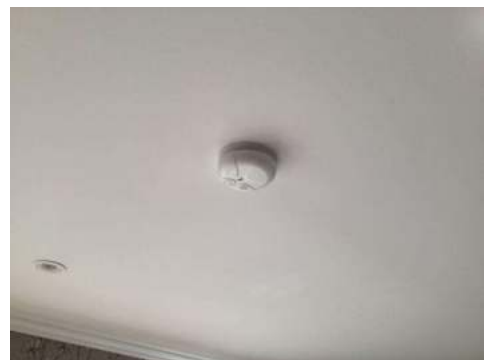
Røykvarsler i 1 etasje
