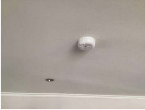
Røykvarsler i 1 underetasje
