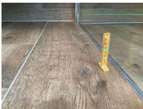
Måling på gulv utforbi nisje på øvrig gulv
