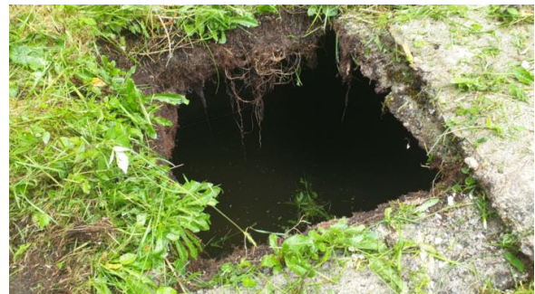
Det ble observert mye vann i tanken.
