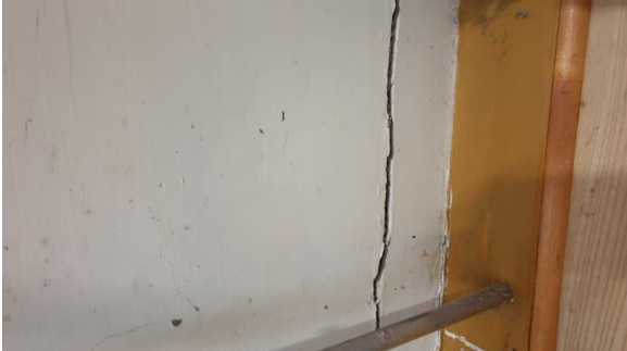
Sprekk i pipe på kjøkken.
