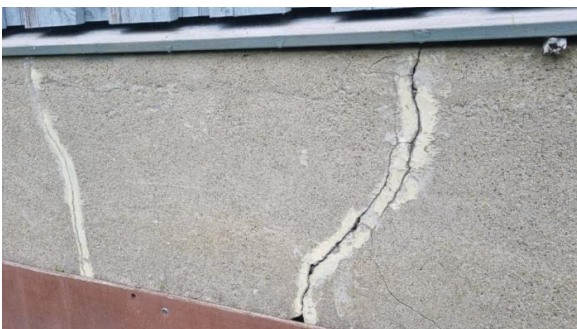
Sprekker i grunnmur.
