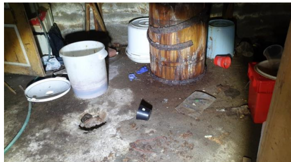
Synlig fukt i den støpte sålen.
