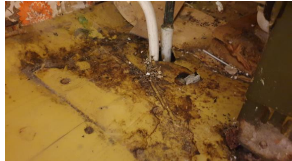
Kontroll av rørgjennomføringer. Utette gjennomføringer.
