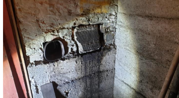
Sotluke er erstattet av en løs stein.
