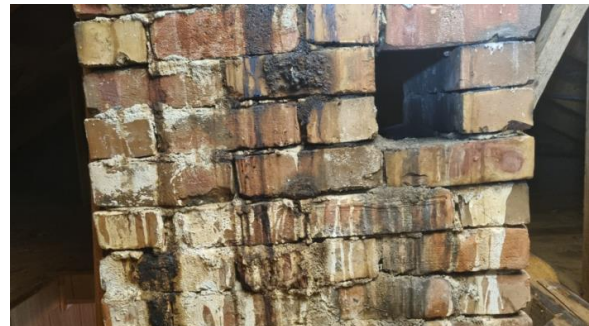
Pipe er upusset på kaldloft og har rennemerker etter sot. Det ble fuktmålt i sotmerker på befaring og ingen forhøyede verdier ble påvist.
