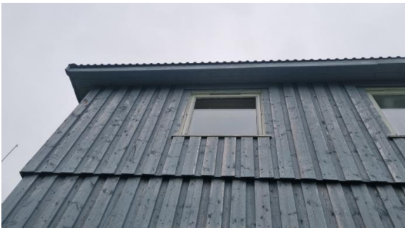
Kledningen er værslitt og har behov for overflatebehandling.
