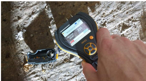
Fuktmåling i kjelleryttervegger viser forhøyde verdier.
