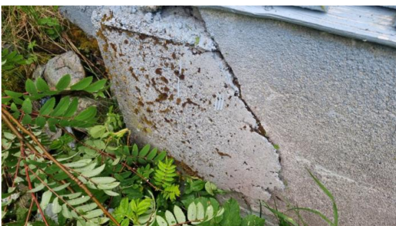
Sprekker i grunnmur.
