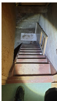
Trapp til kjeller mangler rekkverk og håndløper.
