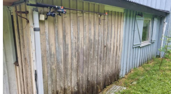
Råteskader i vegg på tilbygd del.
