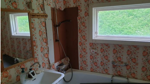
Våtrommet er i en tilstand som krever en totalrenovering av rommet.
