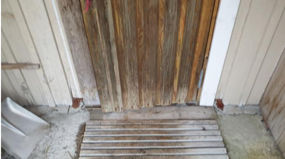
Hovedinngangsdør er utvendig værslitt.
