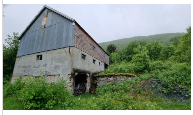
Fjøsene har vedlikeholdsbehov.
