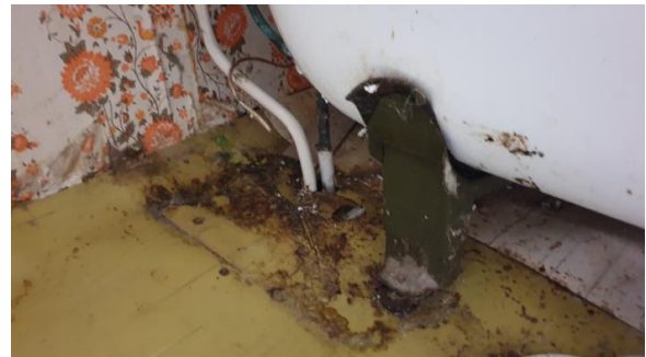
Irr på vannrør rør bad/vaskerom m/servant.
