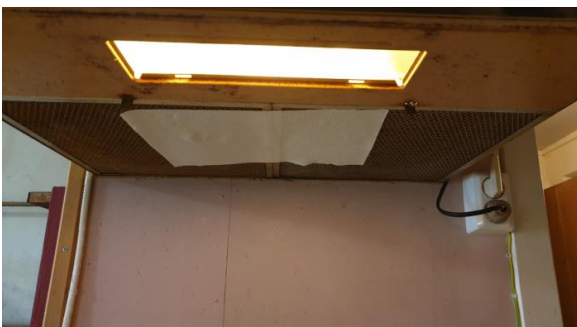
Test av avtrekksfunksjon, avtrekket fungerer tilfredsstillende.
