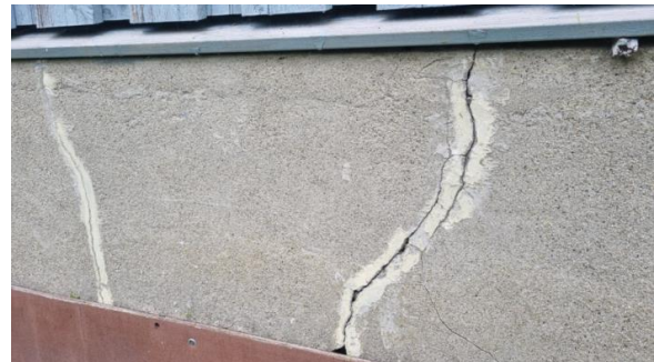
Sprekker i grunnmur, det kan ikke utelukkes at sprekkene går videre under igjenkledd konstruksjon.
