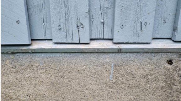
Begrenset lufting av kledning mot grunnmur.
