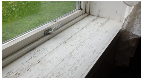
Fuktsvell og malingsavflassing i vindusforing.
