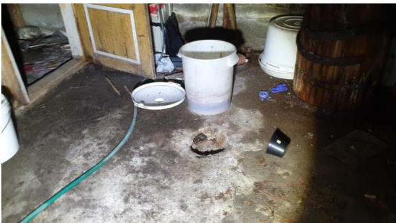
Soilsluk i gulv i uinnredet kjellerrom.
