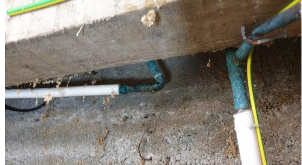
Irr på rør.
