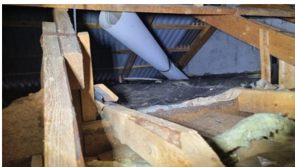
Inspeksjon av kaldloft over tilbygget inngangsparti. Mye muselort ble observert.
