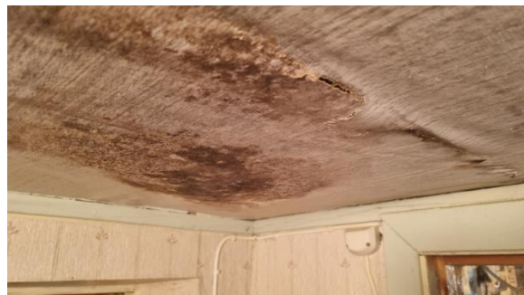
Fuktmerker/soppvekst i himling i bod loftsetasje.
