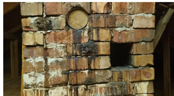
Ventilhull i pipe på kaldloftet.
