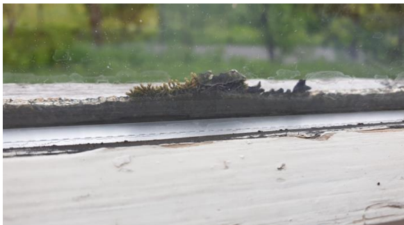
Enkelte vinduer er mosegrodd på utsiden.
