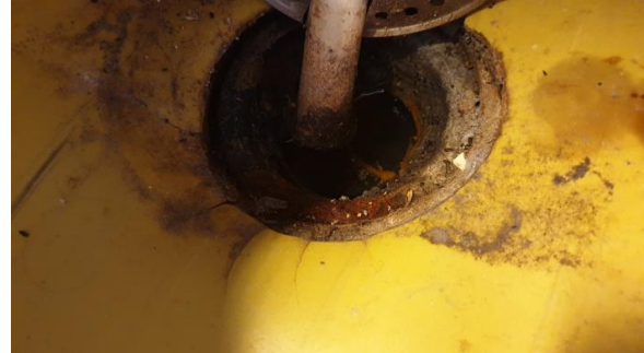
Kontroll av sluk. Ikke tilfredsstillende avslutning av belegg mot sluk. Sluk av eldre dato.
