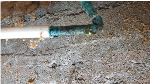
Lekkasje og kraftig bend på rør.
