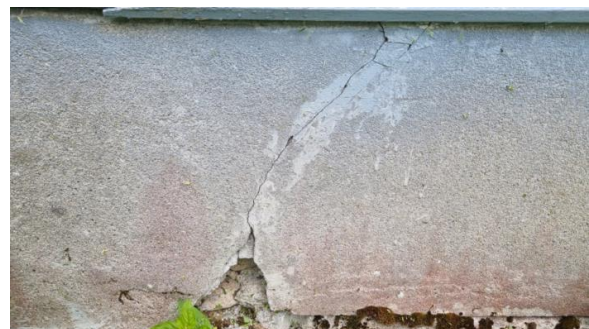
Sprekker i grunnmur.
