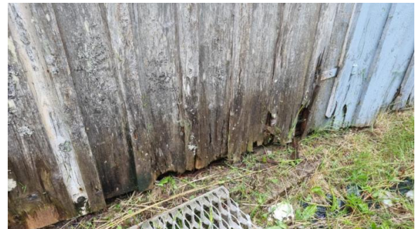
Dør mot vest (i mellomgang) er råteskadet.
