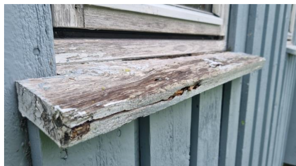
Vannbrett på boligen har ikke beslag, og flere vannbrett er råteskadet og værslitt.
