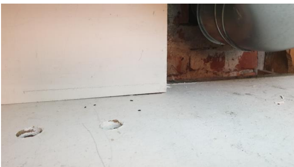
Det ble observert muselort ved ventilatorør fra kjøkken, og en del muselort ved vedovn kjøkken.
