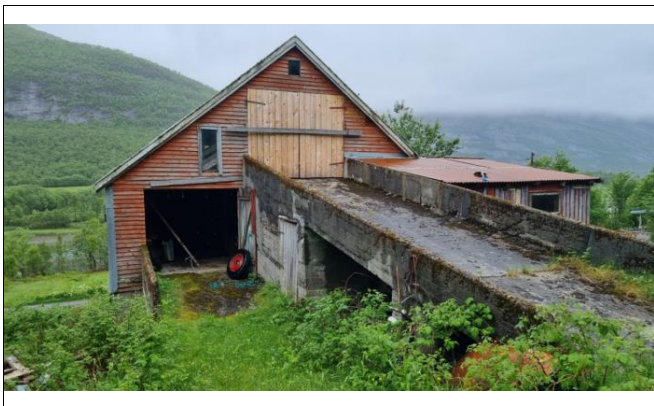
Fjøsene har vedlikeholdsbehov.
