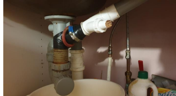
Kontroll av røropplegg, rørsjøter er provisorisk tettet og det er plassert en bøtte i benken for opptak av evt drypplekkasjer.
