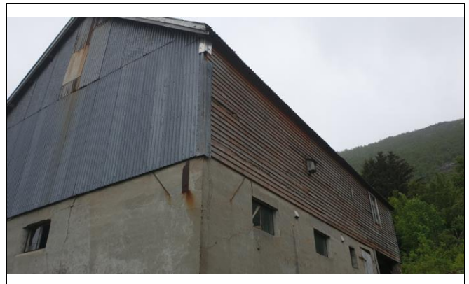
Fjøsene har vedlikeholdsbehov.
