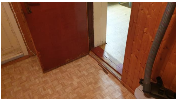
Skader i belegg.
