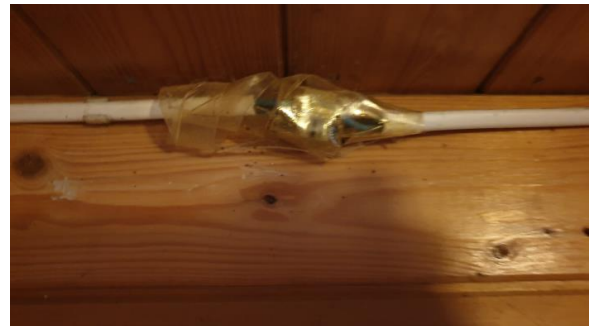
Ufagmessig skjøt av el-ledninger.
