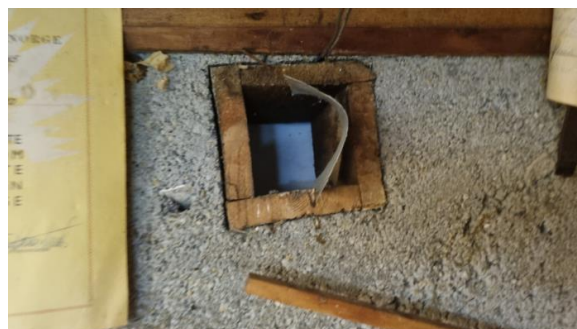
Ventiler på kaldloft opprinnelig del er igjennkledd.
