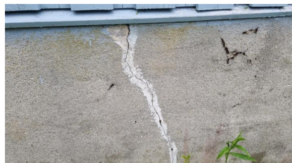
Sprekker i grunnmur.
