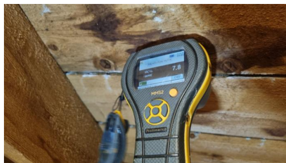
Det ble fuktmålt i taktro kaldloft opprinnelig del, ingen forhøye verdier ble påvist.
