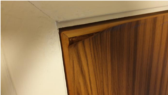
Folie har løsnet på en innerdør.
