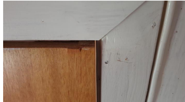
Enkelte dører er trege å lukke og tar i karm.
