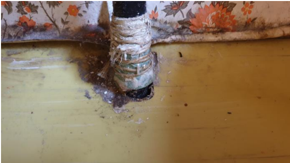
Kontroll av rørgjennomføringer. Utette gjennomføringer.
