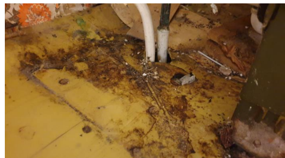
Det er observert mye muselort på bad/vaskerom m/servant.
