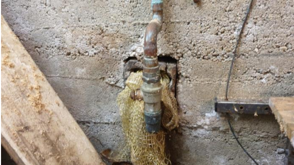
Lukkemekanisme på innvendig hovedstoppekran er knekt.
