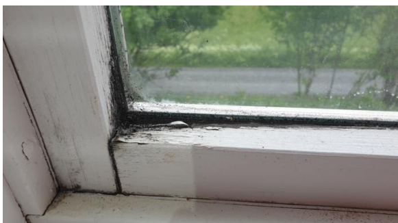
Flere vinduer med råteskader og svartesopp.
