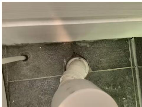
Viser skade i overflate og tettesjikt.
