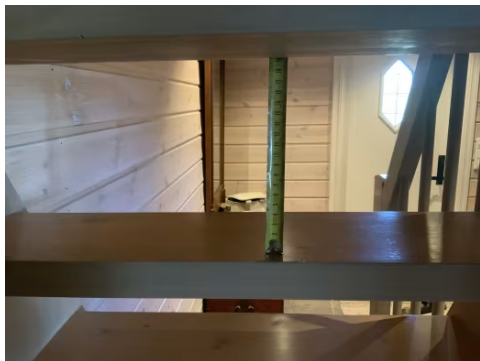
Viser målt åpning mellom trinn.
