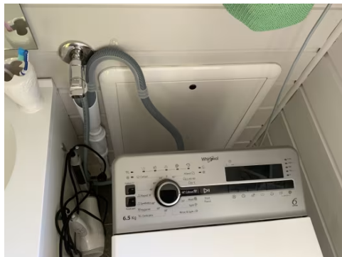
Viser plassering av fordelerskap.
