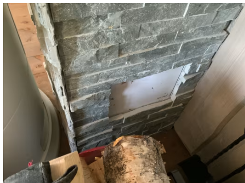
Viser kort avstand mellom sotluke og brennbar materiale (panel).
