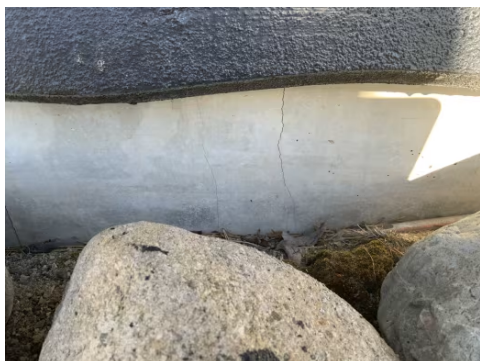
Viser mindre riss i ringmurselementer.
