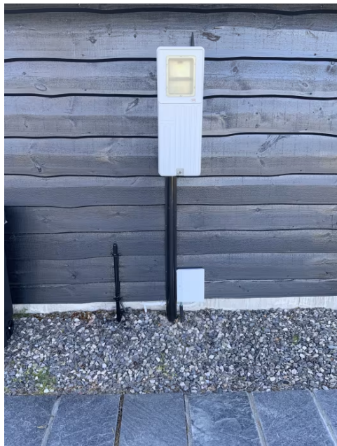
Viser utvendig inntak / målerskap.
