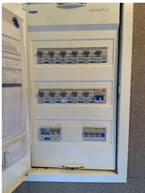
Viser sikringskap med automatsikringer.
