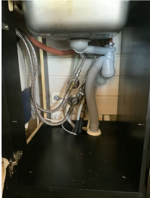
Viser vann- og avløpsinnstallasjoner under kum.
