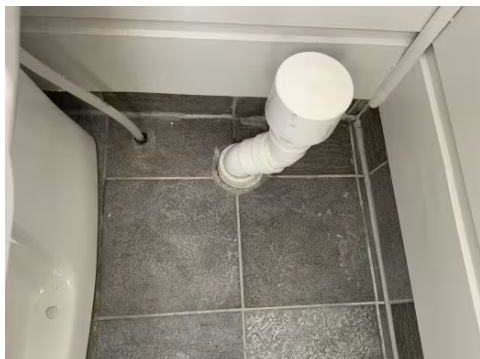
Viser lufting med vakumventil på bad.
