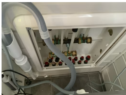
Viser fordeler og rør i rørsystem.
