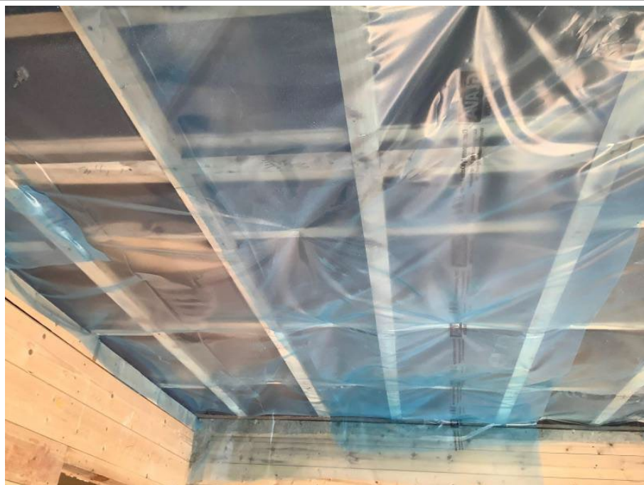
Ny plastfolie i himlingen over stuen, oppmontert etter skaden
