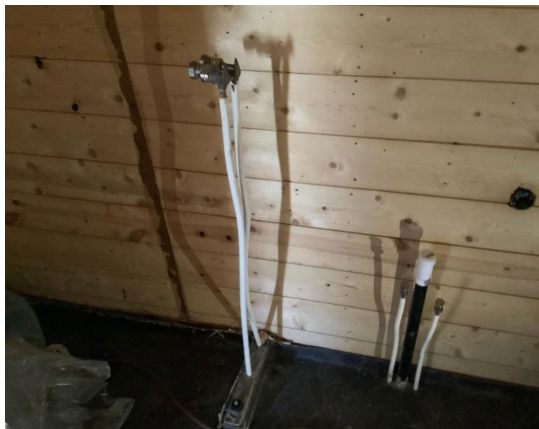
Skaden skyldes frostbrudd på et dusjbatteri. Badet var revet før min befaring, bildet viser pluggede vannrør.
