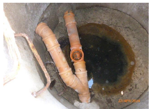
Avløpsrør av plast i septiktank.
