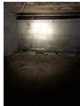
Saltutslag på innvendig side av ringmuren.
