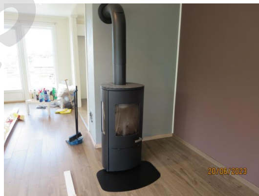
Bilde tatt mot vedfyrte peis ovn i stue m/ plate under, feie luke på siden, mangler godkjent brann plate til gulv under feie luke
