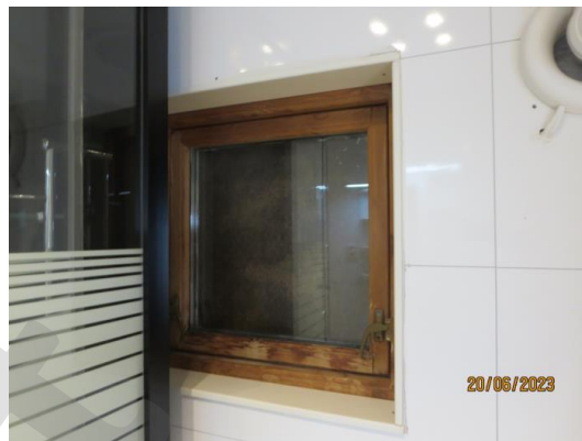
Bilde av vindu i yttervegg v/ dusjkabinettet dels bak vinduet.
