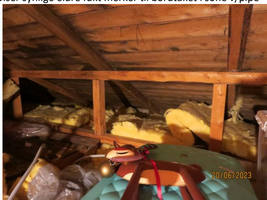
Isolasjon er ført ut mot bordtaket og hindrer normal tilførsel av luft slik det skal være og er viktig.
