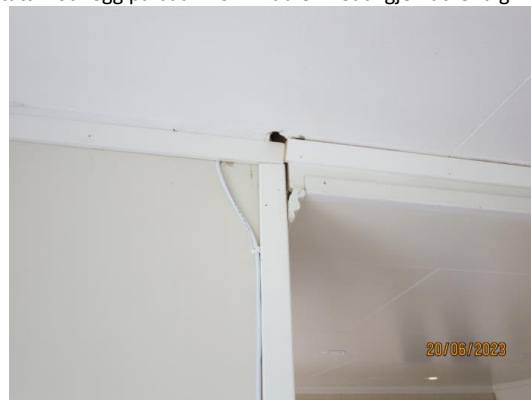
Synlige hull er å se etter gjennomføring, manglende finish flere steder, til tak, vegger, gulv m/ overganger til, rom ikke helt ferdigstilt. Påregnes ferdig stillelse/slutt finish
