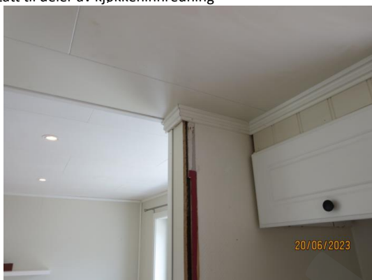
Ikke ferdigstilte arbeider til deler av kjøkkenvegg mot stue
