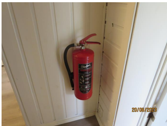
Bilde tatt mot slukke apparat etablert i gang av nyere årgang.
