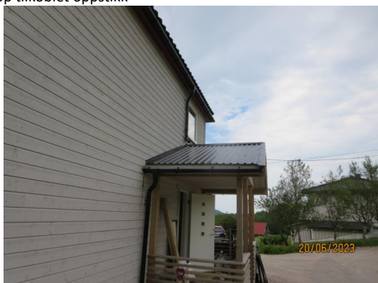
Det mangler spill blikk til takoverbygget adkomst parti
