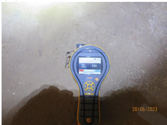
Fukt indikering til gulv i kjeller, sannsynlig grunnet nylig vask/rengjøring/ spyling.
