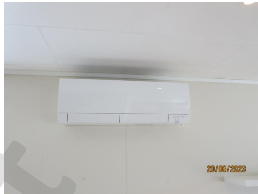
Bilde tatt mot utkast til varmepumpe i stue, har egen kurs
