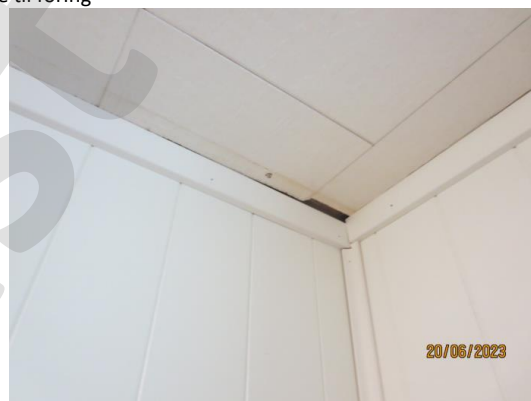
Glippe mellom tak og taklist er flere steder.
