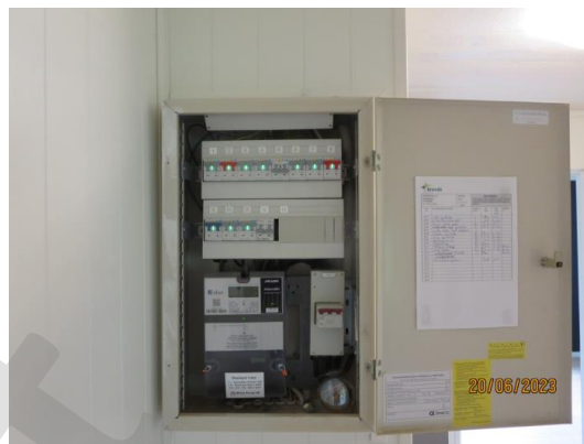
Bilde tatt mot sikringskapet m/ kurs fortegnelse
