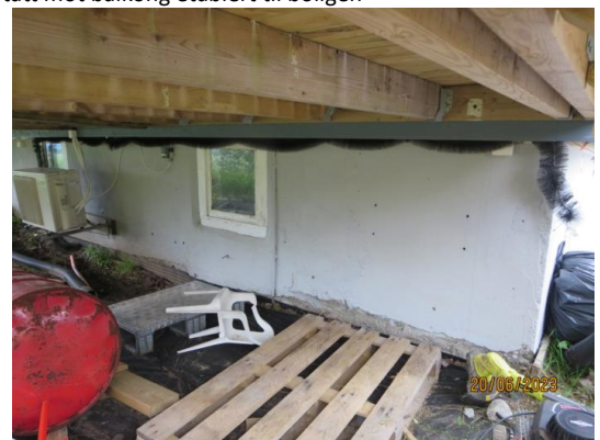
Bilde tatt mot mur under balkong/altan, anbefalt vedlikehold til mur
