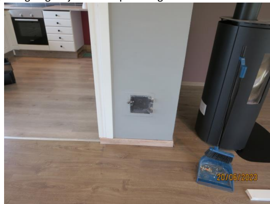
Bilde tatt mot feie luke, mangler godkjent brann plate til gulv under feie luke
