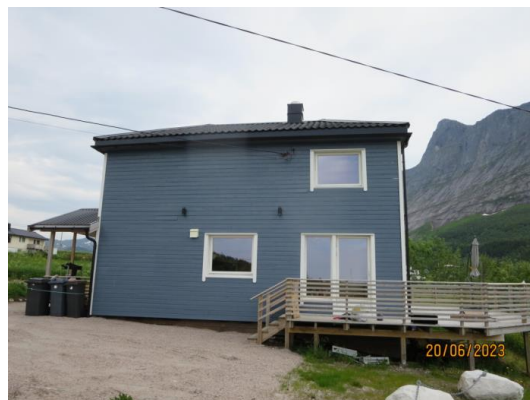
Bilde tatt mot ene fasade beslag over dør/vindu burde vært noe lengre forbi omramnings bordet.
