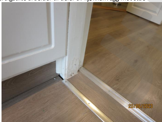
Slitasje, sår til vegg mellom kjøkken og stue, åpning mellom laminat og list til gulvet
