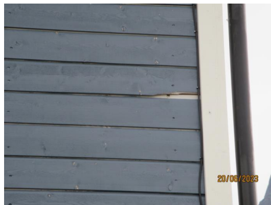
Mindre sårskade til kledning
