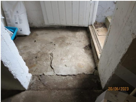
Påregnes noe justering, dør noe slitt
