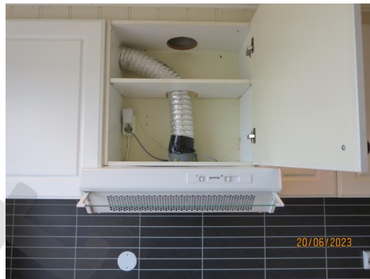
Etablert kjøkken ventilator over plate topp m/ avtrekk ut i ytterveggen
