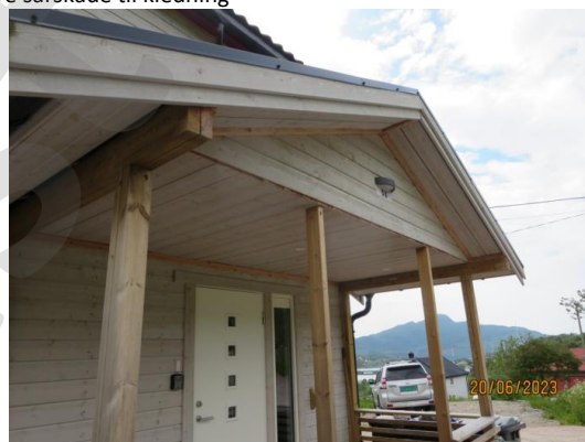
Takoverbygget parti til hovedinngang mangler maling, kun grunnet, div. mindre slutt finish ikke utført
