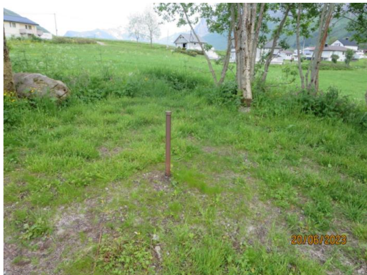
Bilde tatt mot utvendige stoppekran
