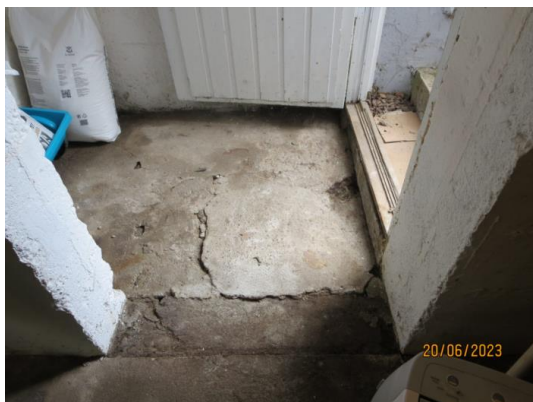
Bilde tatt til del av gulv innenfor kjeller dør, har ujevnheter, riss/sprekke
