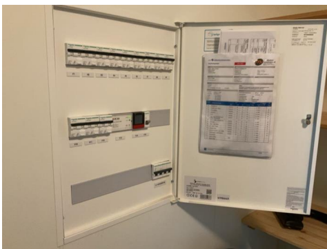
Sikringskap med automatsikringer.
