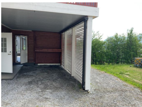
Takrenne og taknedløp.
