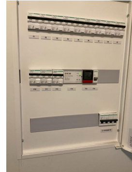
sikringskap med automatsikringer.
