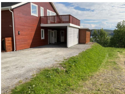
For liten avstand mellom veggkledning og terrenget.
