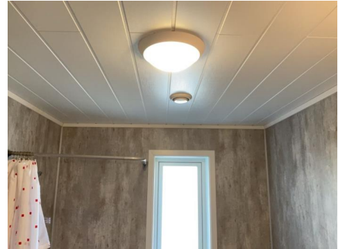
Avtrekksventil i taket.
