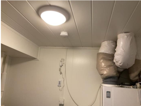
Røykvarsler på teknisk rom.
