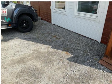
For liten avstand mellom veggkledning og terrenget.
