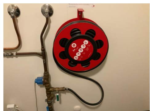
Brannslange på teknisk rom.
