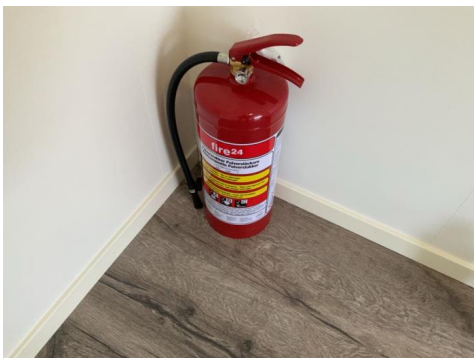
Brannslukningsapparat fra 2020 plassert i gangen.
