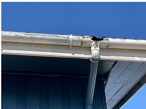
Defekt nedløpskum takrenne.
