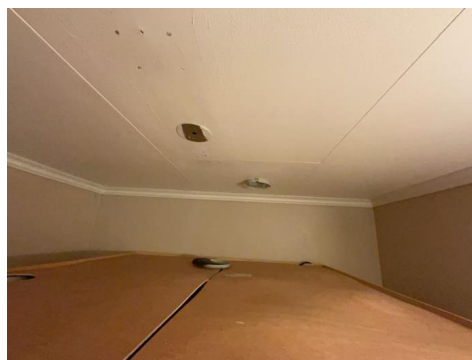
Ventil/ naturlig avtrekk over badstua.
