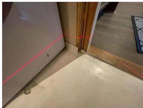
Manglende tetting i overgang ved dør.
